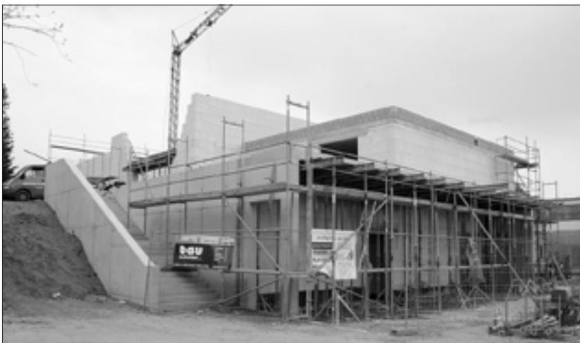
Im Monat April ist wieder ein großer Baufortschritt sichtbar, das Setzen der Mauern fürs OG ist fast abgeschlossen. Auch die Betontreppe für den Außenbereich steht bereits. Nun können die Innenarbeiten beginnen: Im Erdgeschoss kommt gerade der Putz an die Wände, in anderen Bereichen beginnt die Grundinstallation für Elektro/Heizung/Sanitär und der Trockenbau. Die Rettungstreppe am Schulgebäude ist bereits funktionstüchtig.
