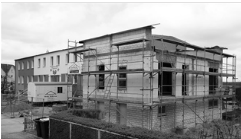
Auch hier haben die Putzarbeiten begonnen und es laufen die Vorbereitungen zum Einbau für den Gussasphalt. Gleichzeitig erfolgen die Grundinstallationen für Elektro/Heizung/Sanitär. In die Fassade werden die Fenster eingesetzt.
