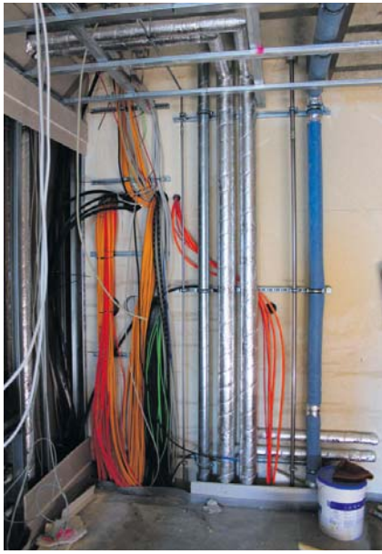
Von wegen mal schnell ein Kabel durch die Wand ziehen: Im neuen Rathaus wurden mehrere hundert Meter diverser Leitungen verlegt (Foto: M. Eckardt)
