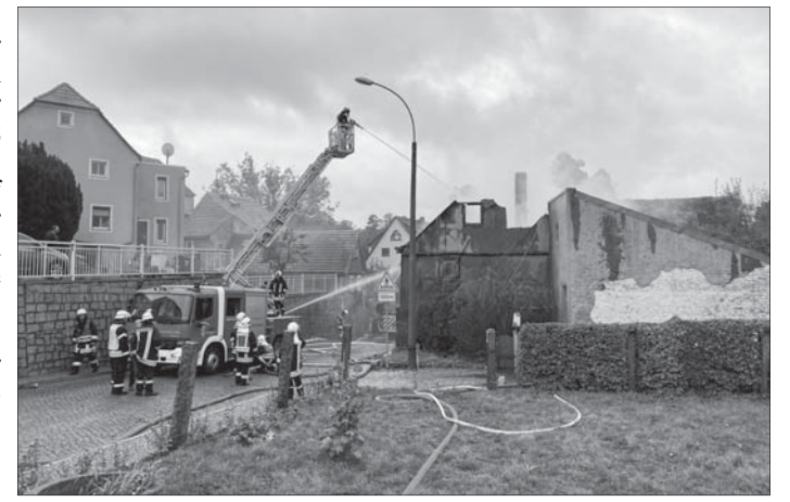
Brand in Kamenz auf der bis Dezember wegen Abriss eines weiteren Gebäudes gesperrten Pulsnitzer Straße
