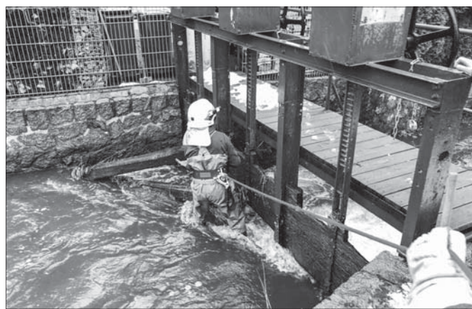
Angeschwämmte Teile einer Brücke am Pulnitzwehr vertopften den Abfluss des Schmelzwassers.
