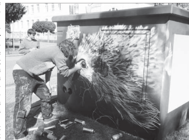
Diese Trafostation wird neu gestaltet.
