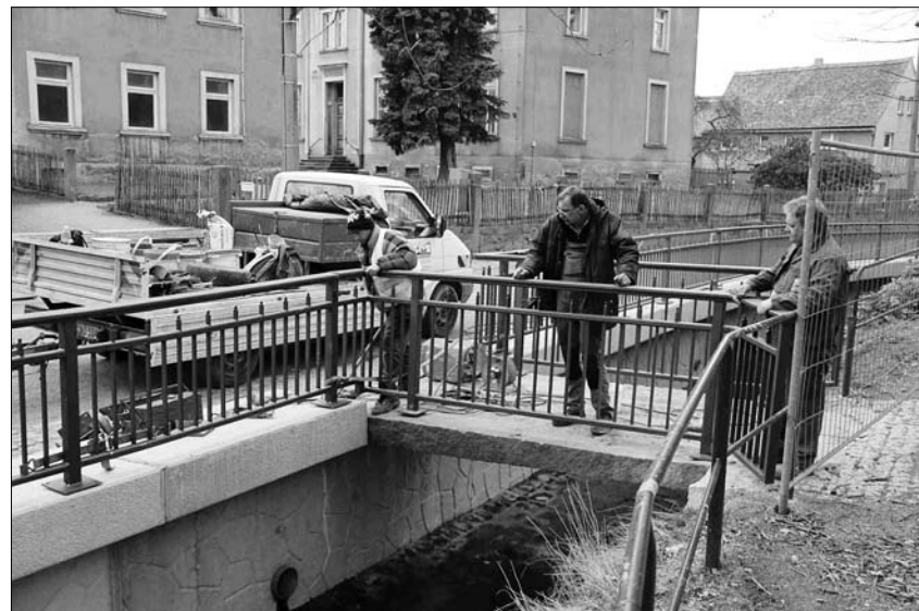
Anfang März wurde das Brückengeländer zwischen neuer Schulstraße und Dammweg montiert und kann seitdem wieder benutzt werden.
