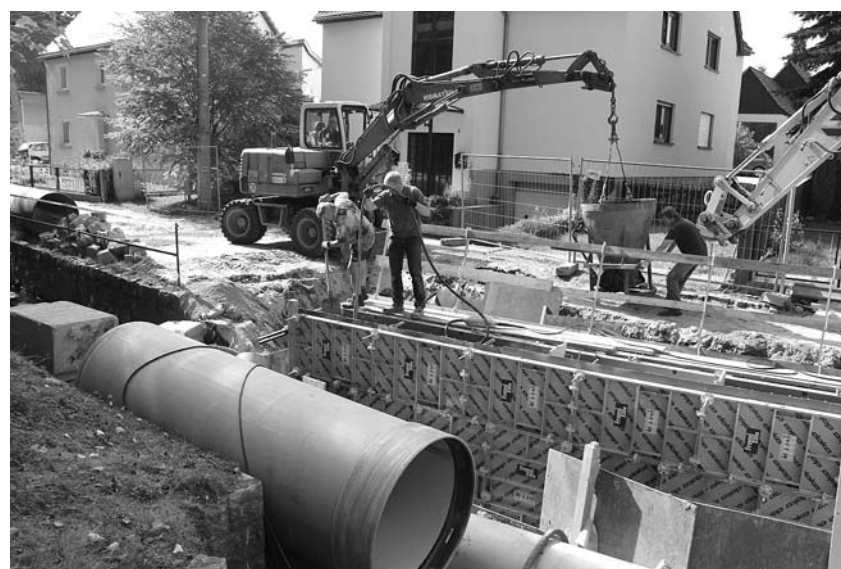
Mitte September konnte wieder ein Stück an der Ufermauer betoniert werden, zügig wird im Anschluss das dritte Segment begonnen
