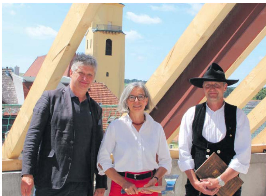
Zum Richtfest kam der zünftige Segensspruch von Zimmermeister Dirk Großmann, dem Bürgermeisterin Barbara Lüke ihren Dank an alle Beteiligten, u.a. Architekt Jörg Möser, hinzufügte (Foto: M. Eckardt)
