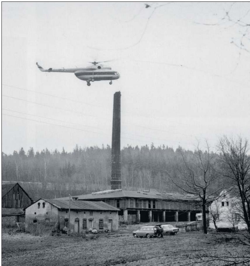
Hubschraubereinsatz zum Abriss des Schornsteins in den 1970er Jahren.
