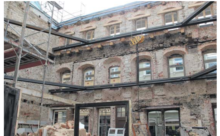
13. April – Im Rathaus sind sämtliche Innenwände entfernt und die Außenmauern wurden durch Stahlträger versteift und vor dem Einsturz gesichert.
