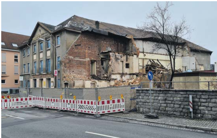
6. Januar – Beginn mit dem Abriss der Sportstätte Kante, zuerst werden die Asbestschindeln vom Saaldach durch eine Spezialfirma in entsprechender Schutzkleidung abgedeckt.
