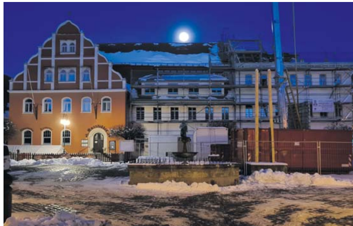
4. Januar – Die Sanierung des Rathauses beginnt mit dem Abbruch des Dachstuhl, gefolgt von der vollständigen Entkernung des Gebäudes an der Robert-Koch-Straße.
