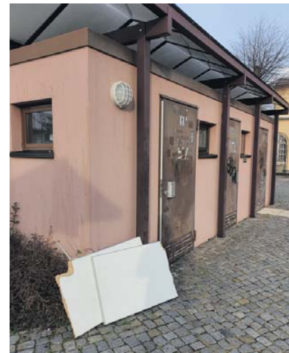
Überreste der Toilettenkabinen vom WC der Herrentoilette am Bahnhof
